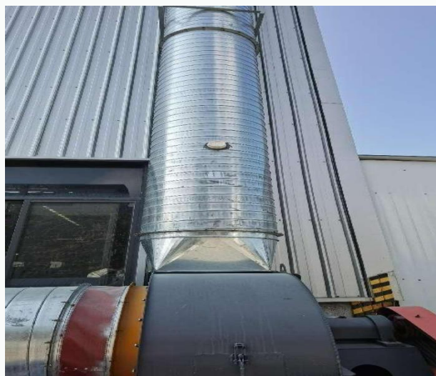
排气筒监测孔
