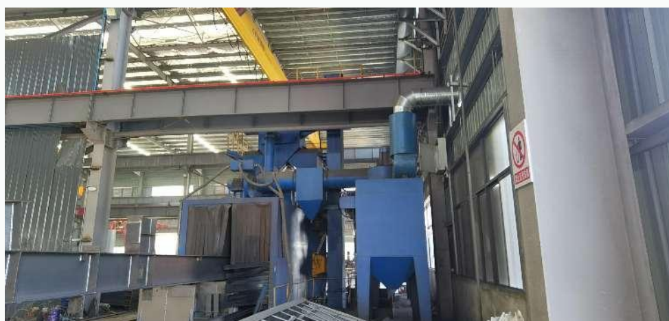
抛丸废气处理设施
