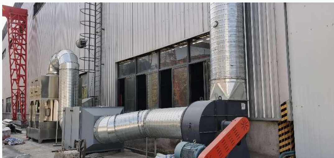
喷漆等有机废气处理设施
