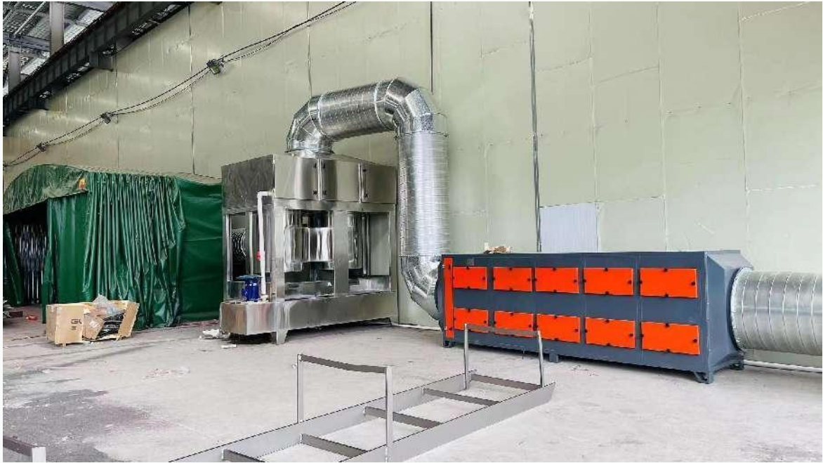
废气处理设施
