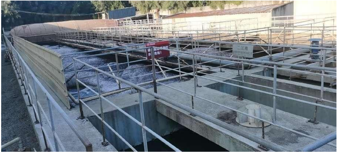
污水处理设施
